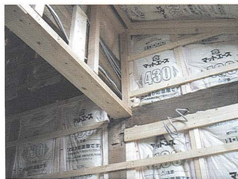
残せるものはできるだけ残す。必要に応じて取り外した材も保管し、他の部分や別の工事で再利用する
