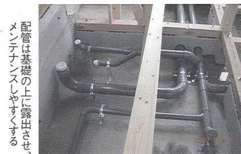
配管は基礎の上に露出させ、メンテナンスしやすくする
