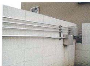
電線の隠蔽(コンフォート若江東町)
